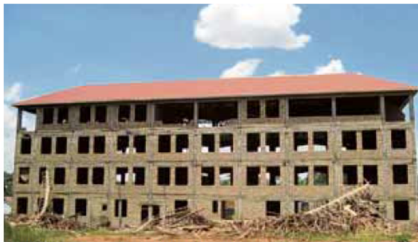
Den Neubau eines Schulgebäudes brachte der Ugandahilfverein dank vieler Spenden zügig voran.
